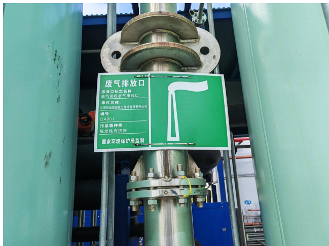
废气排放口标志牌
