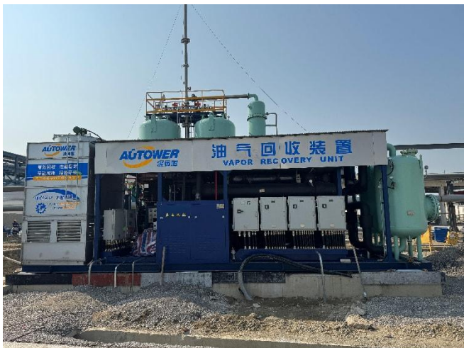
油氣回收裝置
