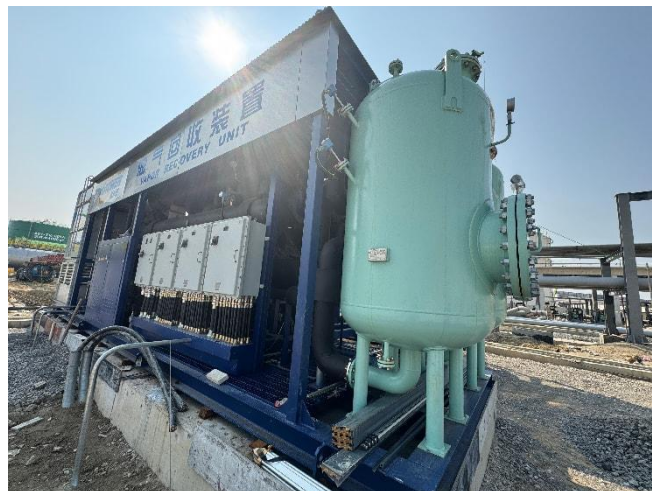
油氣回收裝置
