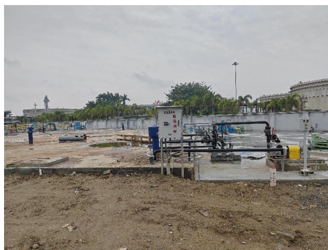
含油污水收集池阀门井
