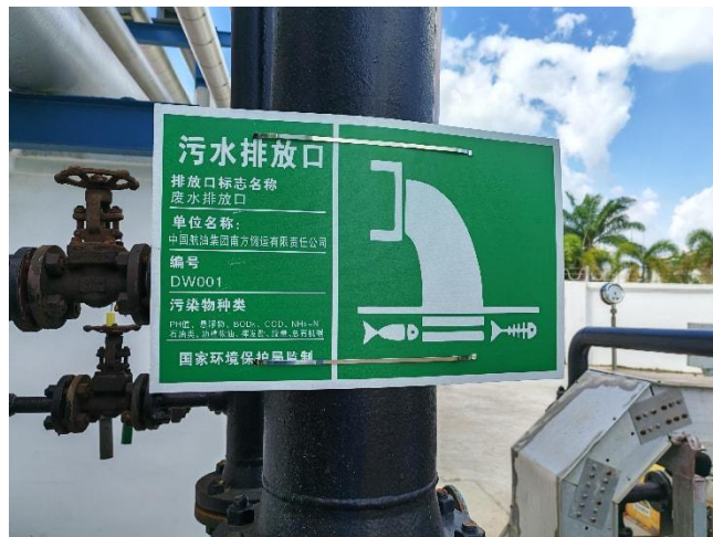
废水排放口标志牌
