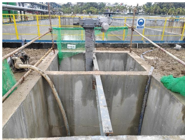
雨水监测池阀门井
